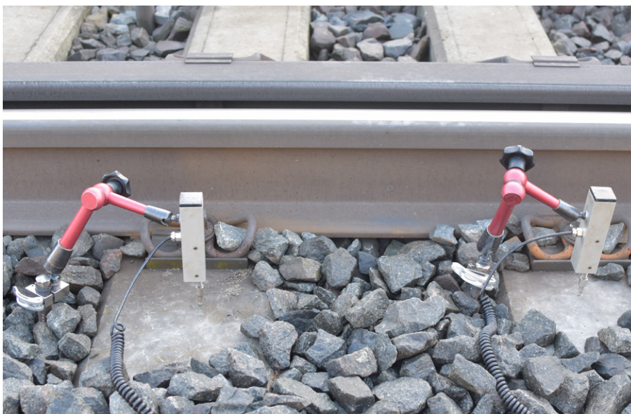
Abb. 4: Messung von Schwellenhohllagen am Beispiel einer Radlenkerfahrtschiene
