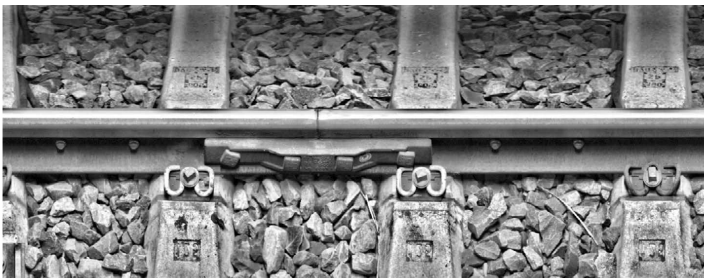
Abb. 4: Beispielhafte Aufnahme eines Isolierstoßes durch das Gleisvideosystem
