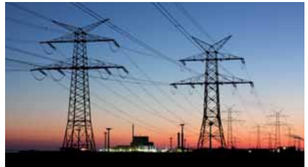
Stromleitung des öffentlichen Landesnetzes
